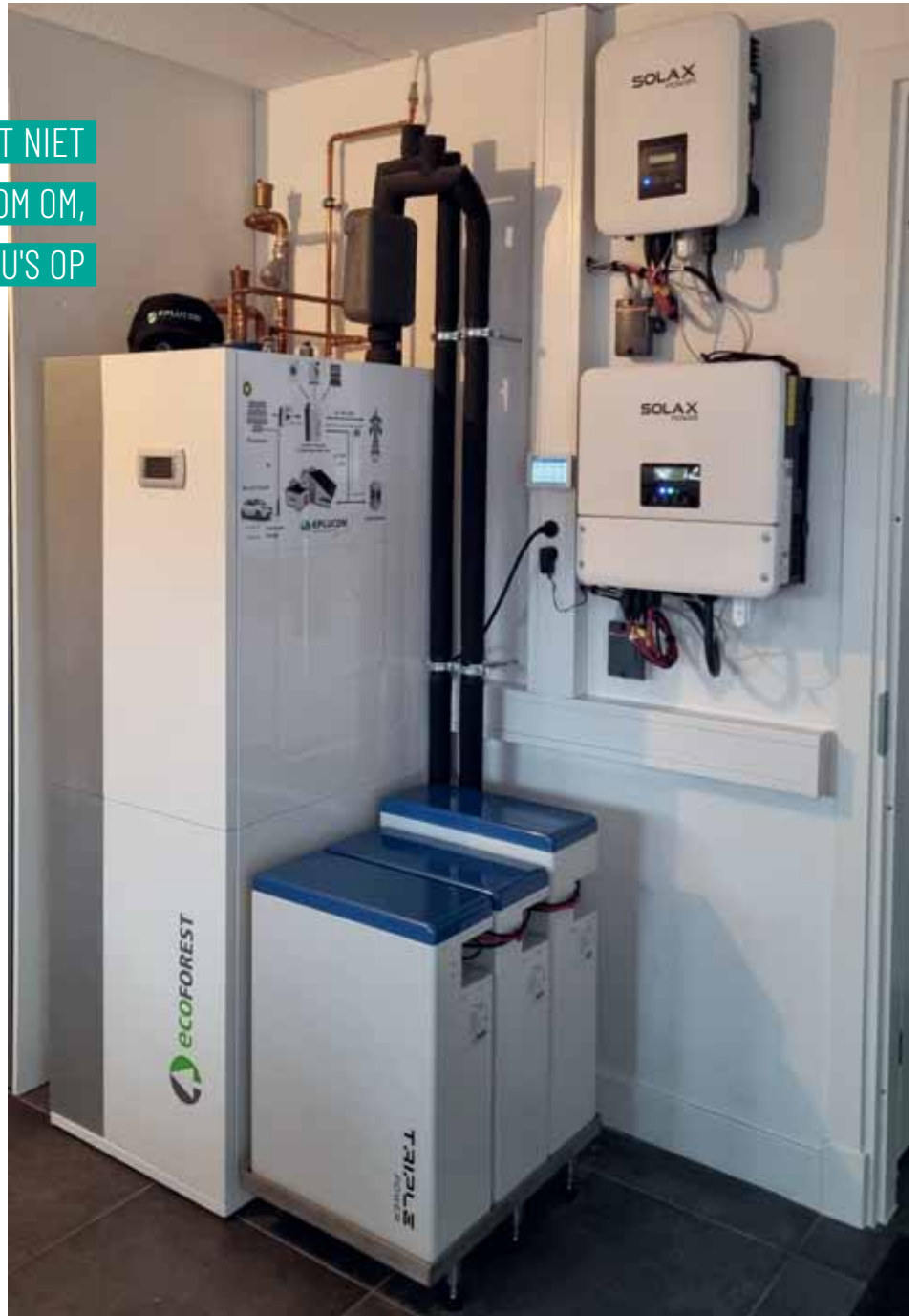
De warmtepomp van 9 kW met 165 liter grote boiler, hybride omvormer en accu's met een opslagcapaciteit van 17 kWh.
